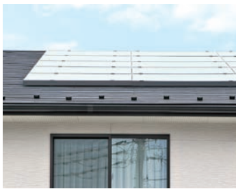
スレート葺きの屋根に搭載した太陽光発電パネル
