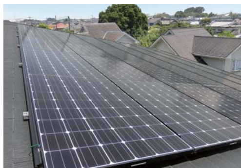
ZEHの原動力として屋根に搭載された9.1kWの太陽光発電パネル
